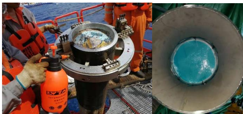
高气体阻隔性水溶焊接充氩封堵材料在工程现场施工照片
